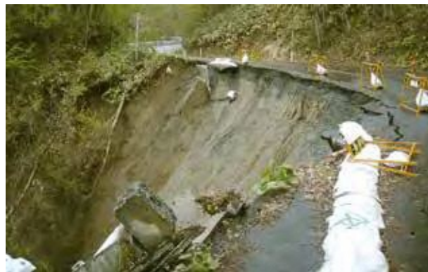
斜面崩落（一般県道戸来岳貝守線 三戸町）
