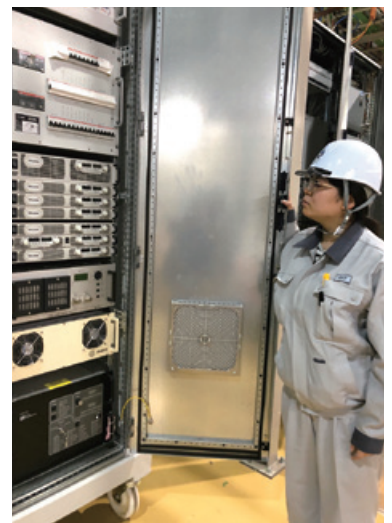
電源室の中で高周波モジュールの動作を確認
